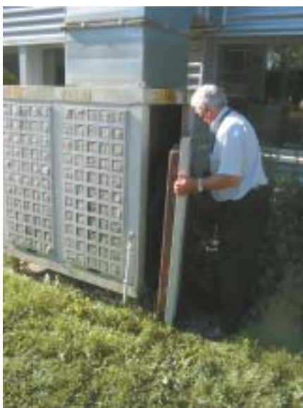
Au CAT de Pamiers, Le groupe est posé au sol devant le bâtiment, pour un accès facile sans charger la toiture
