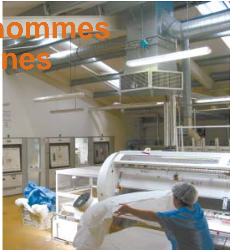
Les diffuseurs à double grille directive de flux, au dessus de 'engagement
