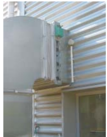
Le volet électrique réglable qui régule le débit via une télécommande à l'intérieur du bâtiment, simple mais efficace
